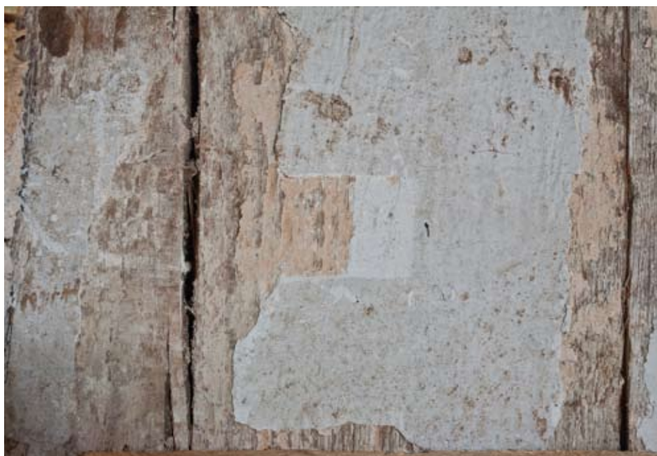
Odkrywka w partii świadka w prezbiterium pokazuje zły stan zachowania polichromii. Zidentyfikowano dwie warstwy: warstwę gruntu i warstwę farby wierzchniej zapewne w technice chudej tempery.
