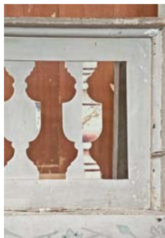
Odkrywka w partii tralek łóż kolatorskich. Po prawej tralka z dobrze zachowanym wtórnym wymalowaniem.
