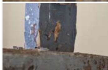
Na krzyżu widoczne bordowe wymalowanie pod warstwą błękitnego wskazujące na pochodzenie z tej samej epoki co najstarszy zachowany szalunek.
