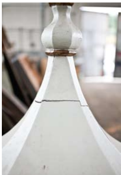
Pęknięcie podłoża w partii nakrywy.
