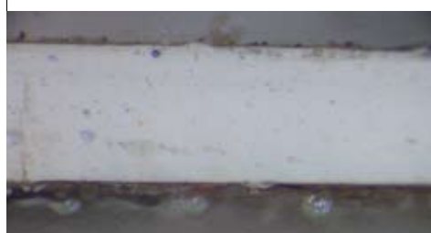
Na przekroju próbki pobranej ze zwieńczenia widoczna warstwa pozłoty przykryta grubą warstwą gruntu.
